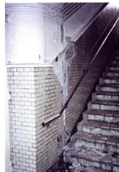
a) 神戸高速大開駅 階段部の被害
