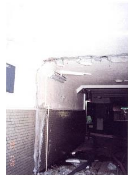
b) 神戸高速大開駅の通路部の被害
