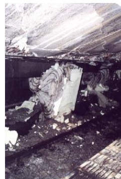
c) 神戸大開駅の中柱の被害
