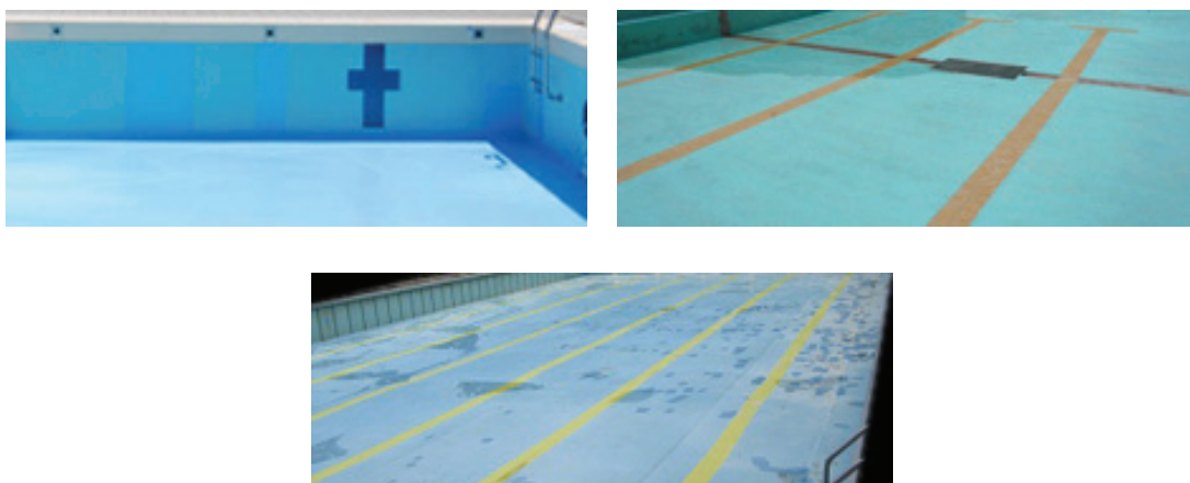
図 4-1 5 使用した水槽のイメージ写真 (上左：綺麗，上右：普通，下：劣化が進行している)
